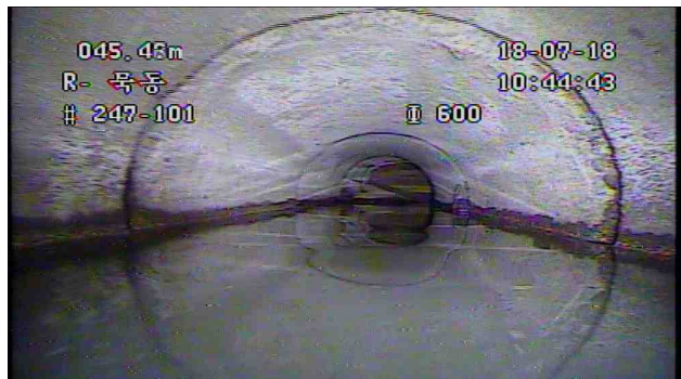
역구배로 인한 관내 체수 및 이음부 파손
