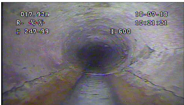
하수관로 노후화로 인한 파손
